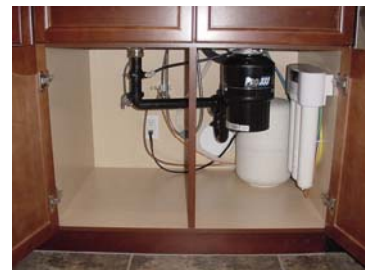
KAPOLEI (Ho'Olu Landing-Makakilo) Installed 7/6/07
