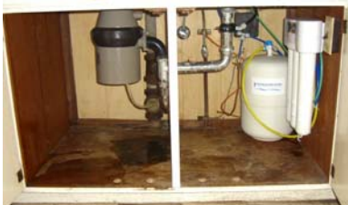
Kaneohe (Kapunahala) Installed 1/8/09
